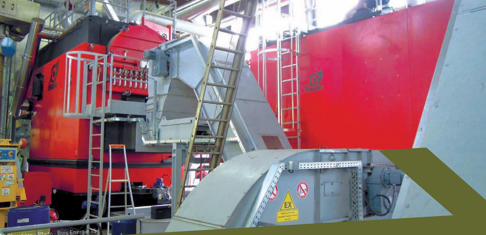
Chaudière - Photo : Bois Energie 15
